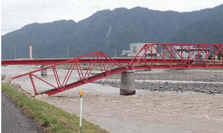
崩落翌日 2019年10月14日 諏訪形から
